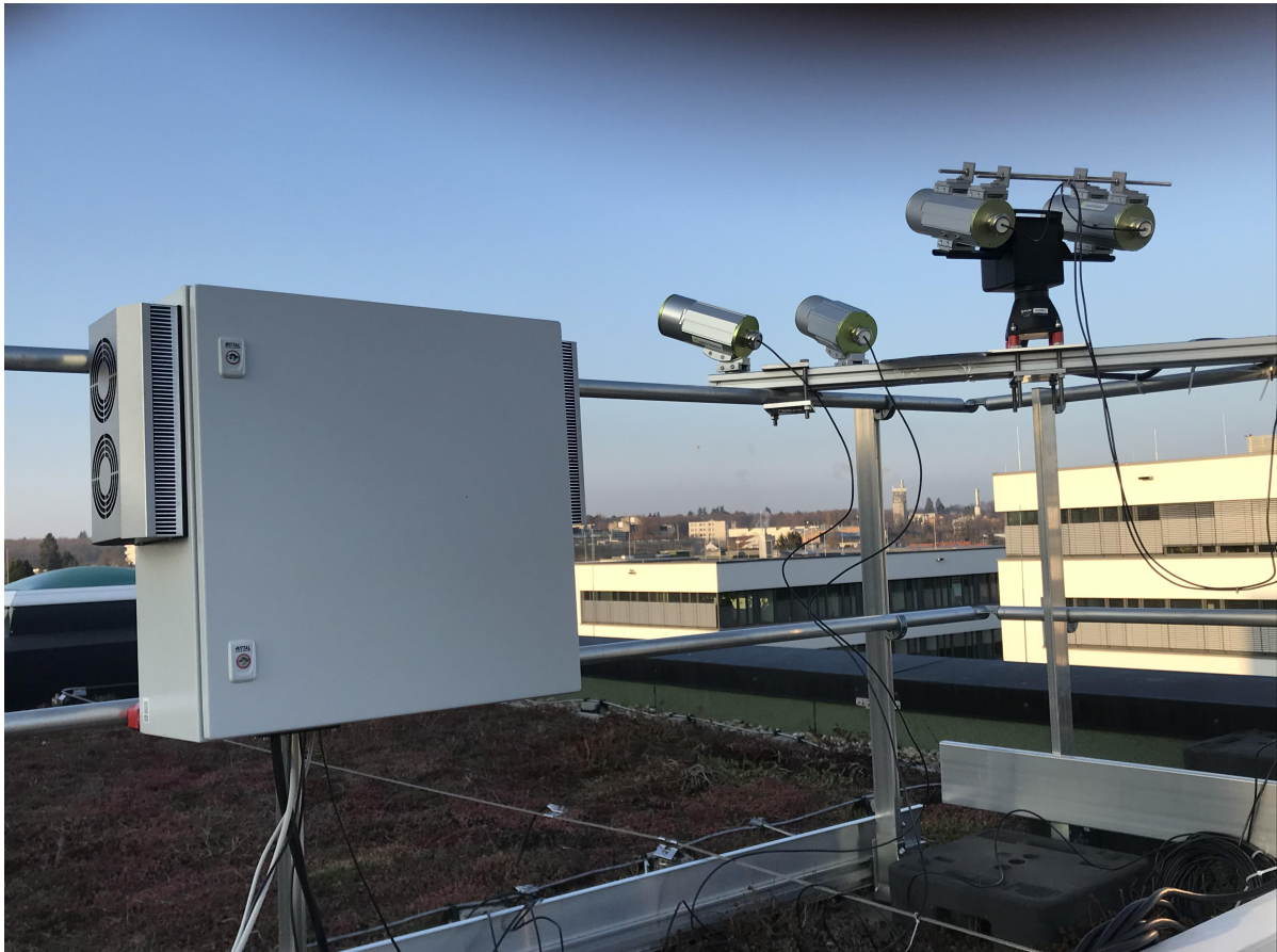
Abb. 3: Testinstallation des BirdRecorder Systems IPC-2 auf dem Dach des ZSW in Stuttgart mit klimatisiertem Schaltschrank, statisch montierten Kameras sowie Schwenkneigekopf mit Stereokamera paar.
